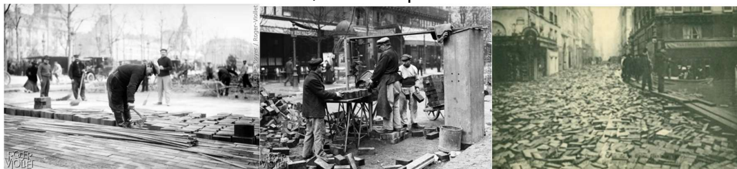
Pavage en bois. Pose de baguettes © J. Boyer/ Roger-Viollet 1908 // Machine à retailler les pavés © J. Boyer/ Roger-Viollet 1908 // Pavés flottants lors de la crue de la Seine © BHVP/ Roger-Viollet, 1910
