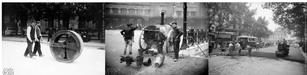
Passage d'un rouleau pour le lissage de l'asphalte © J. Boyer/ Roger Viollet 1908 // Voiture chauffante pour le bitume © J. Boyer/ Roger Viollet 1908 // Épandage de bitume, XX e siècle, © BHVP/RogetViollet
