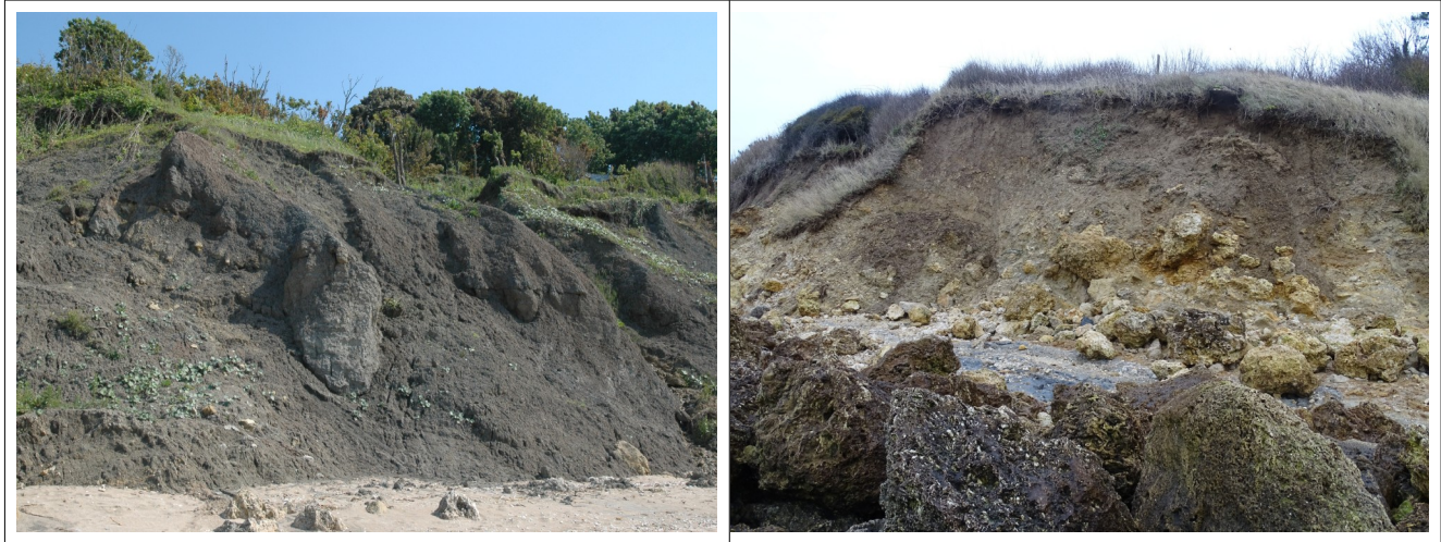
Figure n° 6 : Coulées de solifluxion avec blocs dans leur gangue marneuse pas encore dégagés par la mer, à gauche (cliché J. Avoine) et érosion de la falaise par enlèvement de la butée de pied, à droite (cliché M. Le Blévec).
