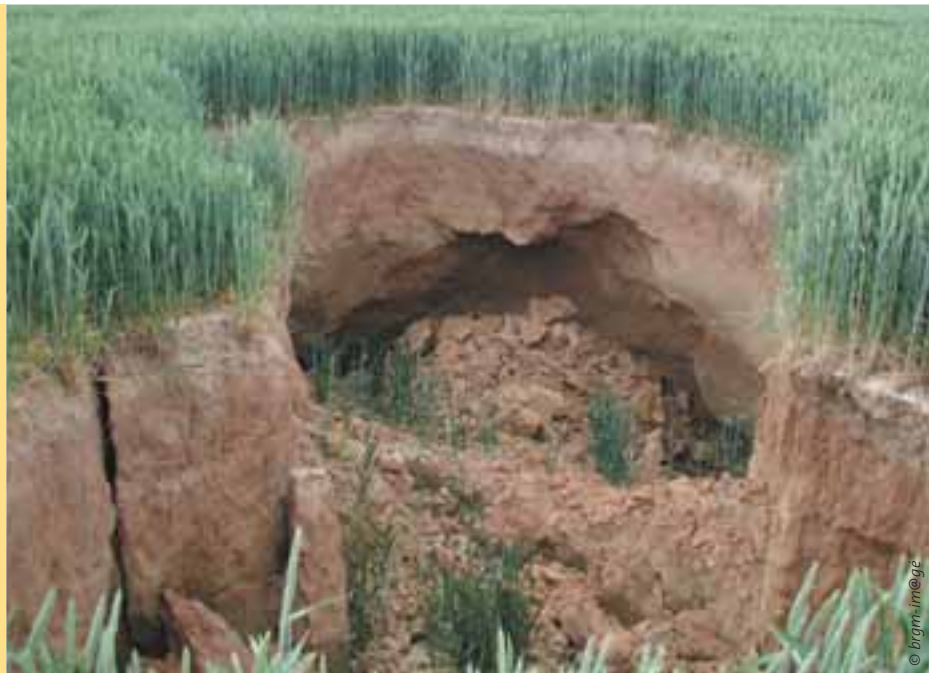
Effondrement à Rouvroy-en-Santerre
